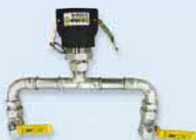
● 給水口配管部
