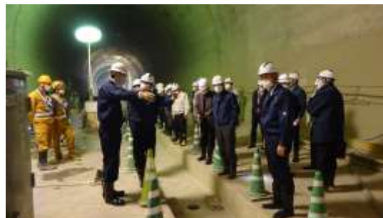
ひび割れの現状確認
