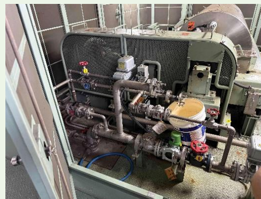
【脱水機更新工事】 「脱水機本体」
