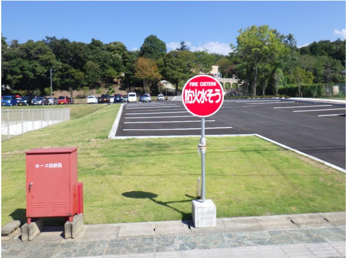
公設防火水槽
