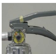
× 安全栓の脱落
