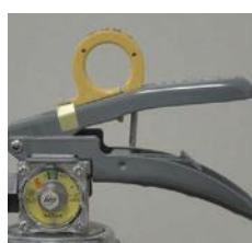
× レバー支えの脱落
