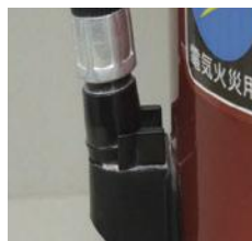
× 消火薬剤の漏れ
