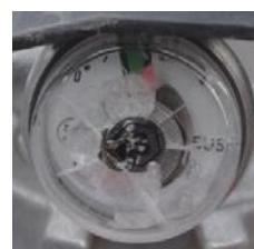
× 指示圧力計の損傷
