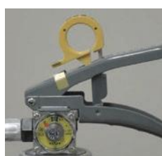
× 安全栓の抜けかけ
