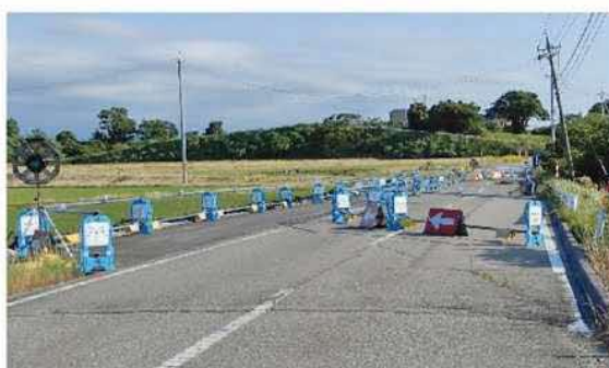
2車線共に通れなくなって いて、左に仮設車線が作られて います。（新保町）
