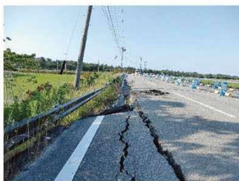
崩れたままの路肩と 傾いたままの電信柱 （同右）
